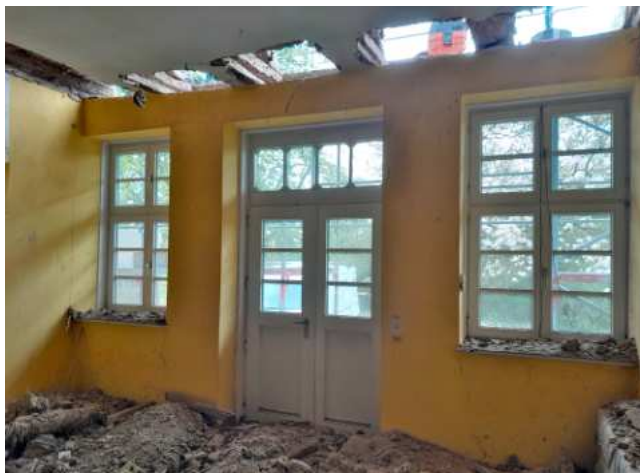
Oben offen unten Bau- schutt – aktuell ist das Wohnen und Arbeiten im Pfarrhaus abenteuerlich.
